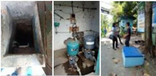
Gambar 5. Mesin pompa air bersih yang ada di Kampung Jetisharjo, RW. 07
